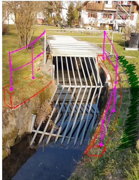
Anpassung Grobrechen auf Höhe Alterssiedlung
